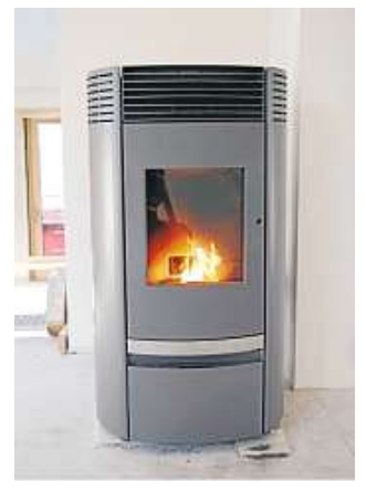
Der Pelletofen: Er heizt das gesamte Haus.
